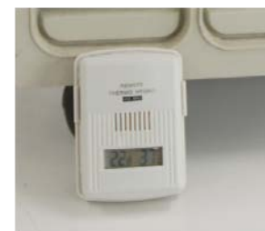
Déshumificateur maintenant la salle de montage à 35 % d'humidité relative (+/- 5%) et thermohygromètre
